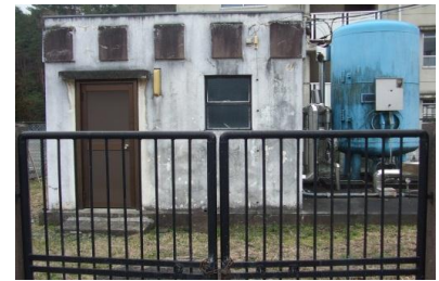
※写真は桂町簡易水道施設
