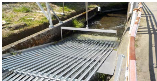
■鹿留地区に設置した除塵機
