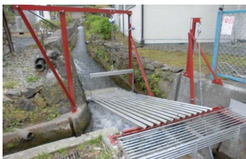
■夏狩地区に設置した除塵機
