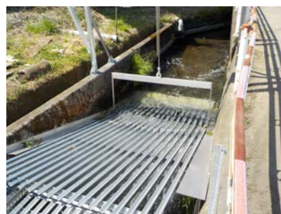
■鹿留地区に設置した除塵機
