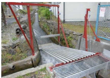
■夏狩地区に設置した除塵機
