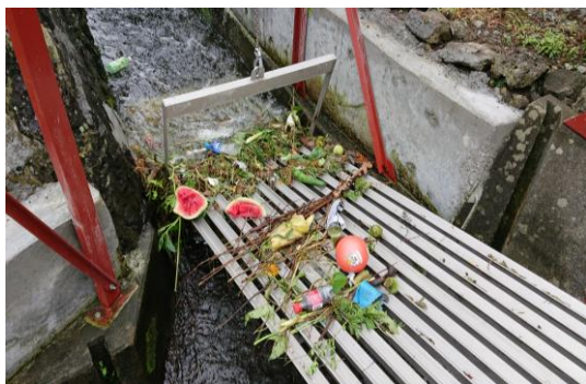
■夏狩地内に設置した除塵機
