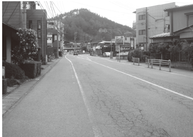
天神通り線(ひび割れ)
