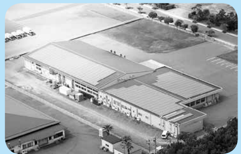
【企業の屋根に設置された 太陽光発電設備】
