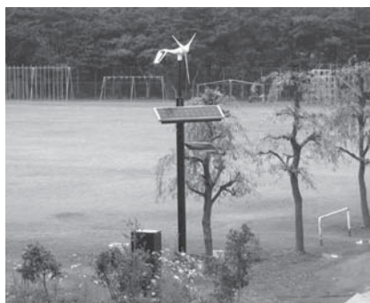
(ハイブリッド太陽光・風力発電装置)
