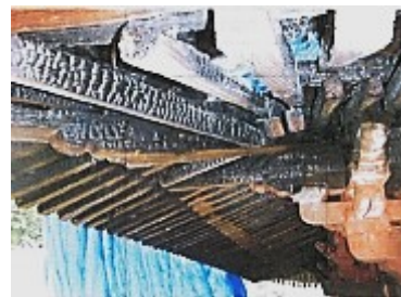
○外部状態 桁、隅棟、垂木 延焼
