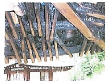
○外部状態 隅棟、垂木 延焼
