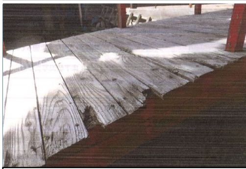
母屋から便所棟 床板の腐朽
