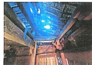
○内部状態 小屋裏 垂木、野地板 全焼
