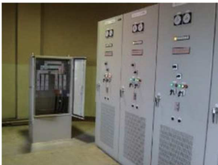
図 4-7 可搬式発電機から給電を受けるための接続盤 (水道施設耐震工法指針・解説 2022 年版 II 参考資料)
