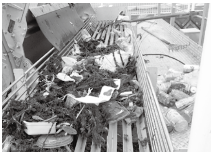
▲除塵機には、1日で草など大量のごみが堆積します。
