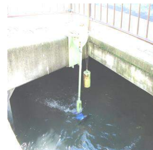
設置されたアクエアUW発電機
